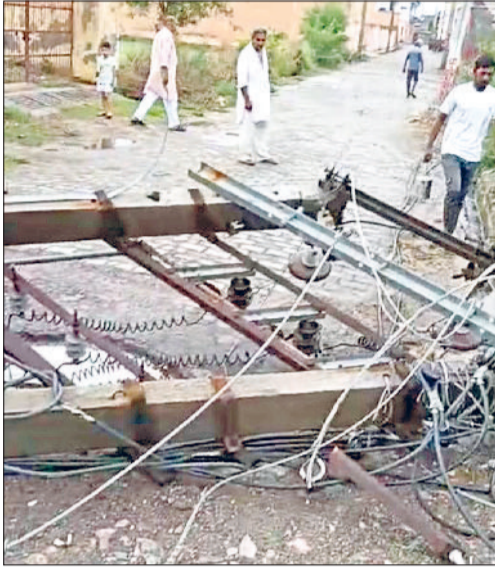
गन्नौर। पोल समेत जमीन पर गिर कर टूटा ट्रांसफार्मर।
