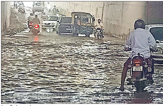
करोड़ों रुपए की लागत से बने अंडर पास में शुरुआत से लेकर अब तक लगातार बरसात होने पर वह बिना बरसात के भी कई बार पानी भरने को लेकर लोग हैरान हैं कि विमान शुरू से लेकर अब तक स्थाई समाधान नहीं करवा पाया है और ना ही इसका पानी भरने का कारण खोज पाया है लेकिन विभाग के अधिकारी फूले पर यह कह कर पल्ला झाड़ लेते हैं कि कहीं ना कहीं अंडरपास की दीवारों से ही पानी का रिसाव हो रहा है, पानी रोकने के लिए उन्होंने आसपास के किसानों को नोटिस भी दिए हैं, बार-बार पानी भरने की समस्या से परेशान वाहन चालकों व लोगों ने सरकार से मांग की है कि इस मामले की विजिलेंस जांच करवाई जाए और निर्माण के दौरान हुई लापरवाही पर संबंधित अधिकारियों व निर्माण एजेंसी के खिलाफ कार्रवाई की जाए, उसके बाद ही जाकर इसका स्थाई समाधान हो सकता है अन्यथा लोग इस तरह ही परेशान रहेंगे।
